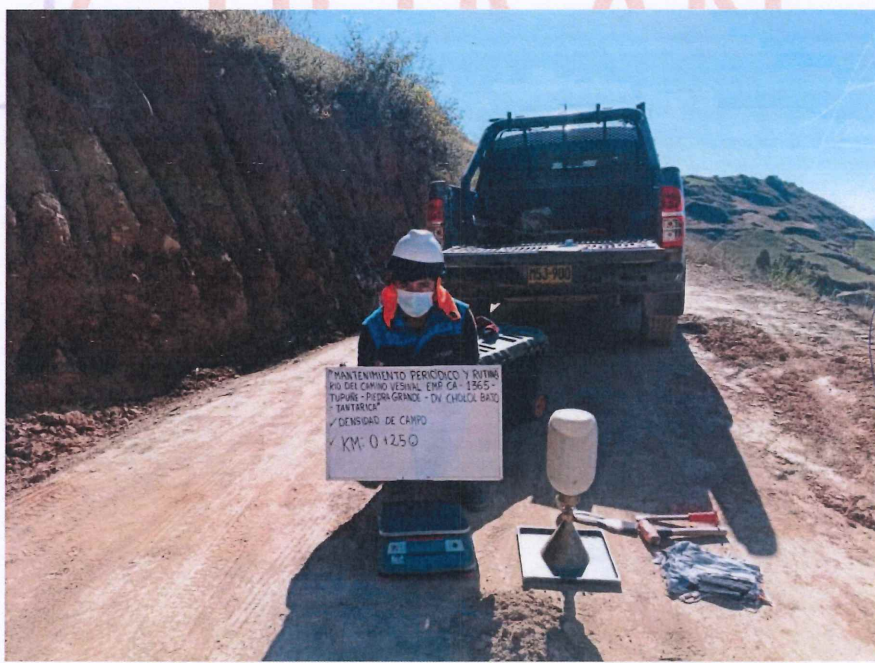
FIGURA N° 2. Ensayo de Densidad de Suelo en Campo. Progresiva 00 + 250 (Método del cono de arena).
